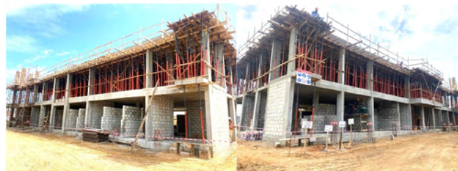
REDISSE IV – Congo : Construction de laboratoire de niveau P2 à Pointe Noire
